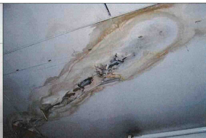
漏水による天井仕上げの損傷
