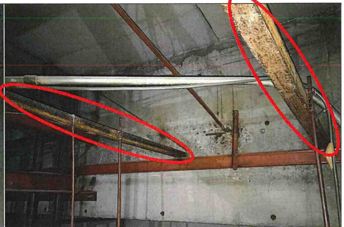
⑫支持構造部（鉄骨部材）の著しい錆・たわみ
