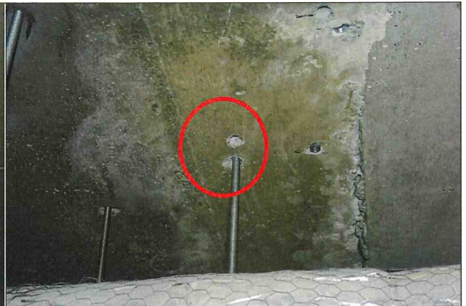
⑧吊り元コンクリートの欠け
