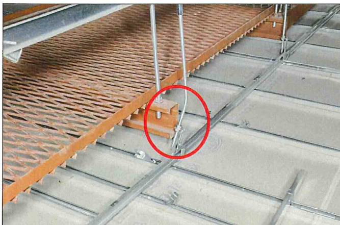
⑬吊りボルト・ハンガーの変形
