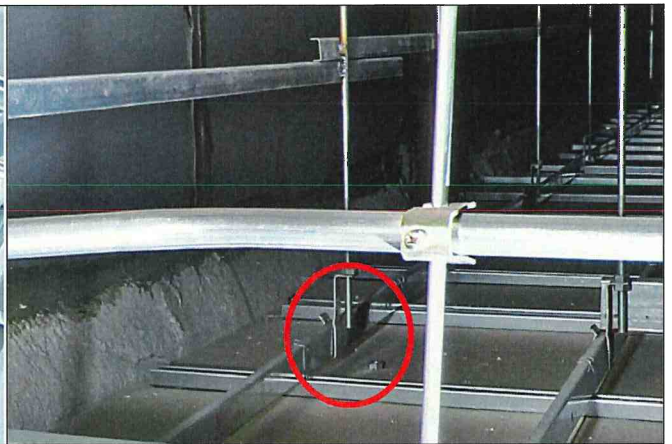
④ナットの脱落
