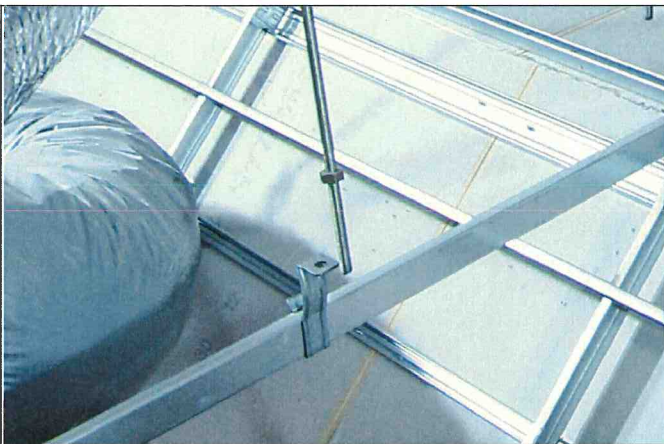
③ナットの脱落によるハンガーの外れ
