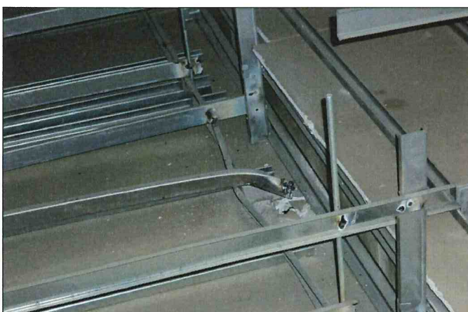
⑮段差部の著しい曲がり
