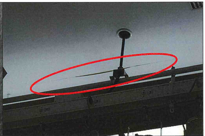
⑩天井面の亀裂
